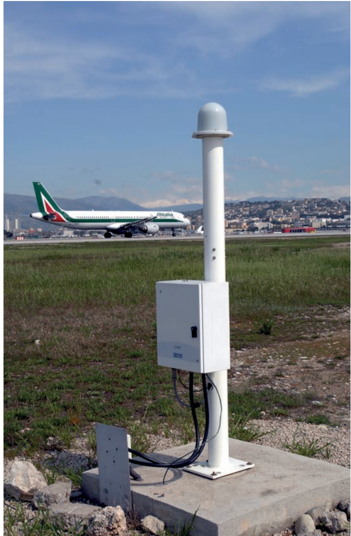
Capteur de foudre sur l'aéroport de Nice dans les Alpes- Maritimes
